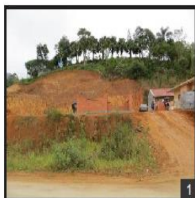
Cortes íngremes em taludes no setor 3.
