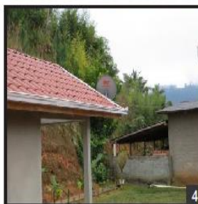
Residência muito próxima a taludes de corte.
